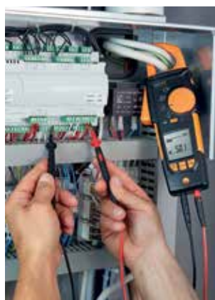
Измерение напряжения в распределительном щитке теплового насоса путем подвешивания прибора.
